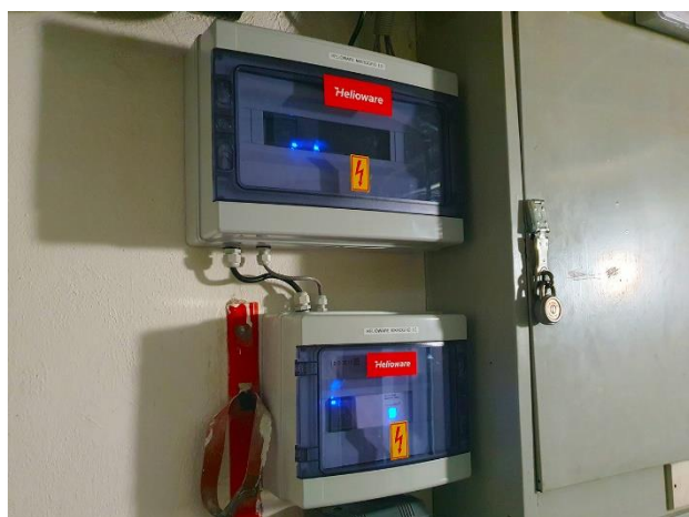
V jednom vchodě musí být řídicí systém mikrogridu LCU a pak brána CCU3
